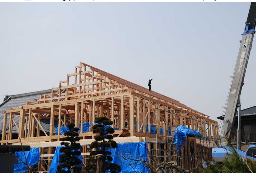
母屋(もや)が取り付けられ大屋根の姿をイメージできるようになりました。
