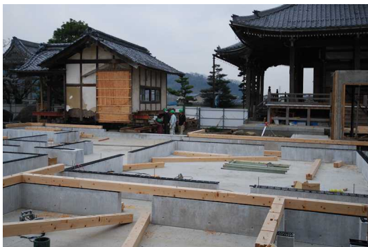
基礎天端には黒いドミノのような基礎パッキンが敷かれ、桧の土台が据え付けられます。
