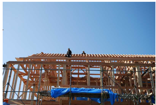
屋根には垂木(たるき)がならび200坪総二階の巨大な屋根の姿になりました。
