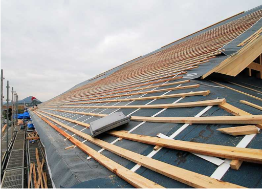
4月13日から屋根工事が始まりました。棧葺という土を使わず屋根を軽くする工法です。
