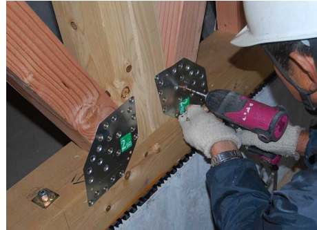
筋交い用の金具だけで480枚強力なボルトで固定されています。
