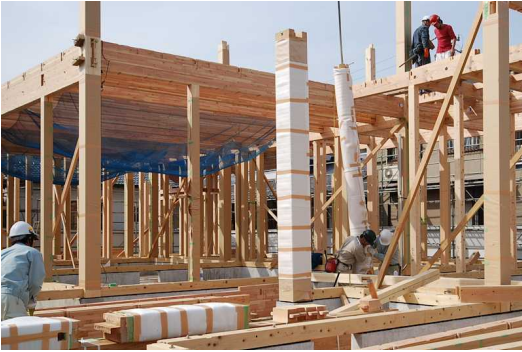
建て方2日目、大黒柱や化粧丸柱を建てる作業がはじまりました。
