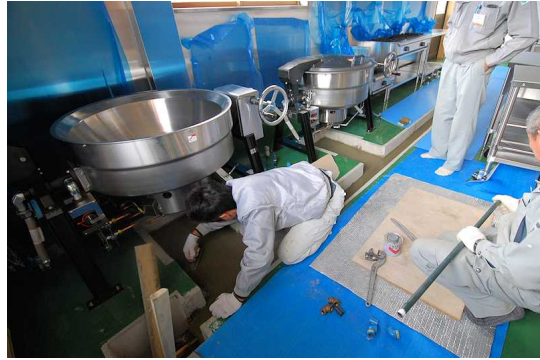
80Lと55Lのガス回転釜が据えられると給食センターのようになりました。
