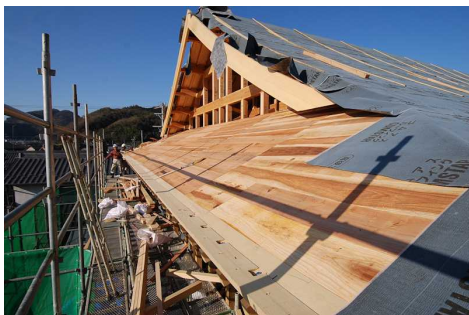
小屋組作業12日目優美な曲線の反り屋根が完成しました。
