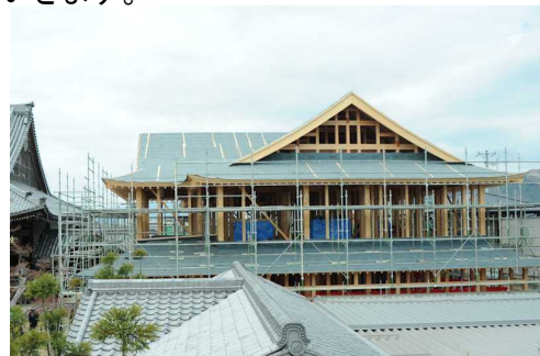
建方21日目大屋根仕舞(しまい)も終わり上棟式を待つばかりとなりました。
